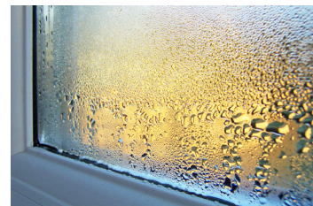
Abb: Aussenkondensat am Fenster
