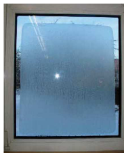
Abb: Aussenkondensat am Fenster
